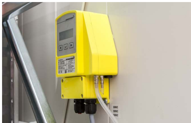
Monitor przepływu powietrza nadzoruje skuteczność wentylacji technicznej.
